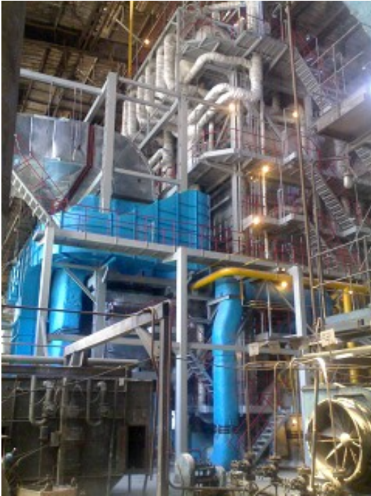
Котлоагрегат Е-100-3,9-440ГМ ТЭЦ ГП «ЮЖМАШ» г.Днепропетровск
